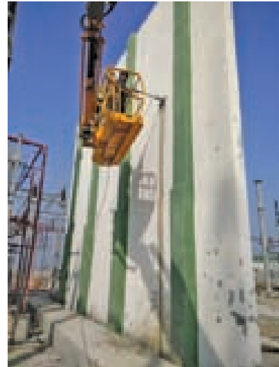
400 केवी उप स्टेशन, ओरेई में फायर दीवार पर एनसीबी टीम द्वारा कंक्रीट कोरों का निष्कर्षण
